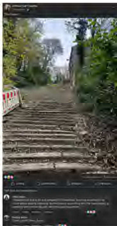
Poste Facebook d'une photographie prise par un habitant du quartier de Sainte-Walburge mettant en évidence la difficile praticabilité des escaliers. (Cuvelier, 2024)
